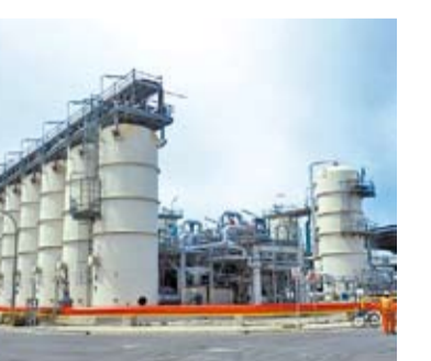
Vapor Recovery Unit.
