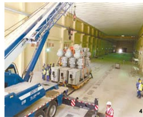
1 밤이 아파온 뉴주베일 380kV 변전소 현장 야경. 2 380kV 가스 절연 개폐 장치(GIS). 3 노무자들이 통제실(LCC: Local Control Cubicle) 케이블을 단말 작업에 한창이다. 4 380kV 가스 절연 개폐 장치를 변전소 건물 내부로 반입하고 있다. 5 임창근 현장소장이 외국인 직원 노무자를 대상으로 안전교육을 하는 모습.
